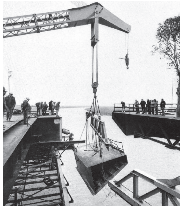
IMAGEN IX.2. Momento de la unión del tablero metálico del puente sobre el río Paraná
